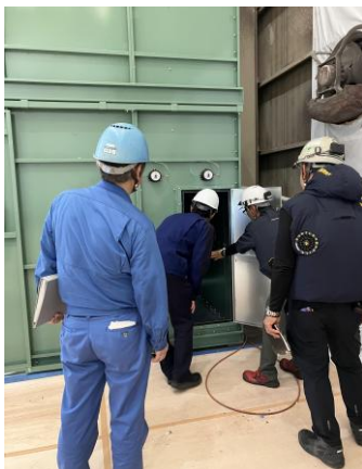
局所排気装置のフィルターや内部の構造もチェック
