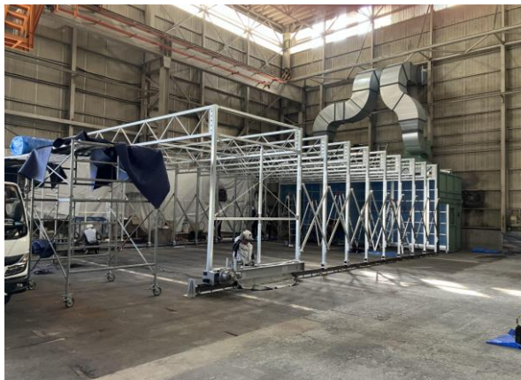
塗装エリアの伸縮式ブースの稼働チェック（全長）
